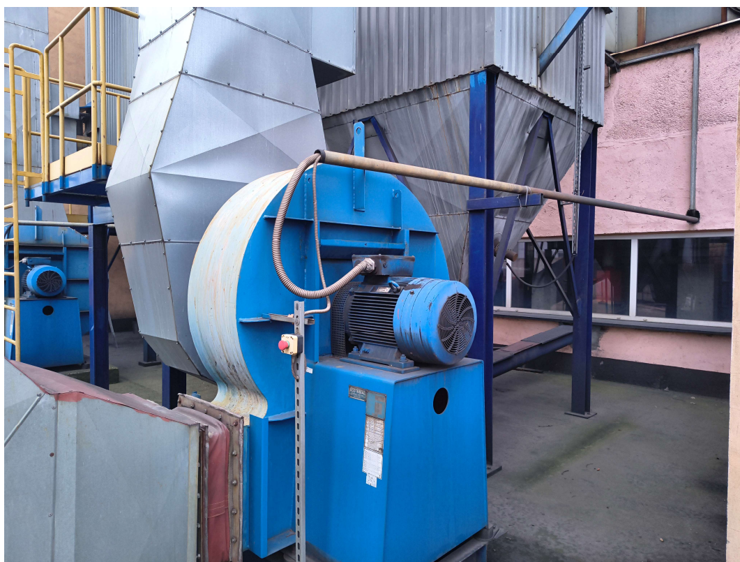
Istniejąca instalacja wyciągu spalin kotła – wentylator wyciągowy.
