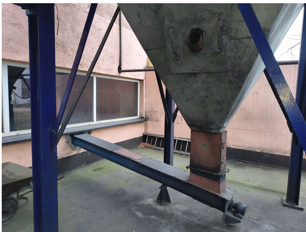
Istniejąca instalacja do transportu pyłów.
